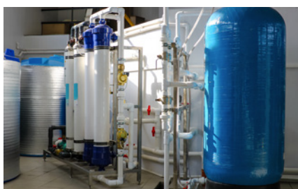
Sistemi di filtrazione dell'acqua
