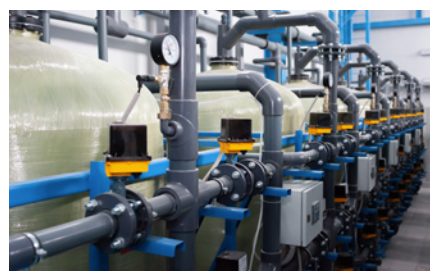
Impianti trattamento acque
