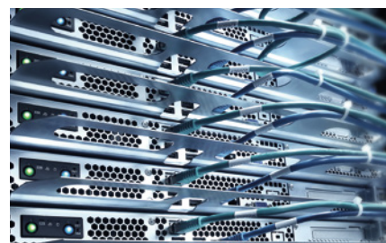
Circuiti elettronici e data center
